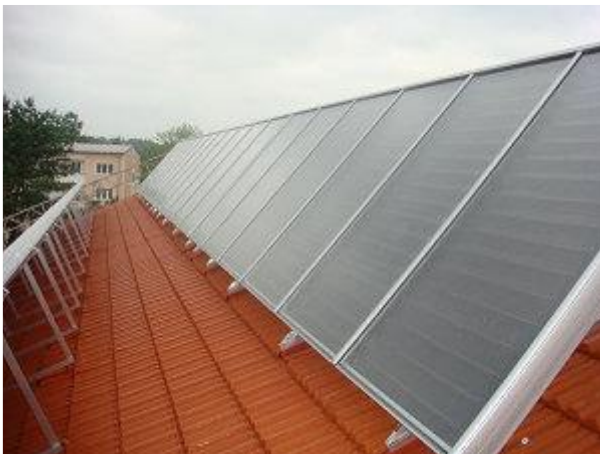
Die Großflächenkollektoren nach der Montage.
