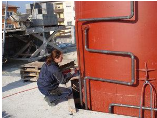
Die Speicherverrohrung wurde komplett geschweißt. Aufgrund der Speicherhöhe von über 14 m mussten Kompensationsbögen wegen der thermischen Dehnung vorgesehen werden.
