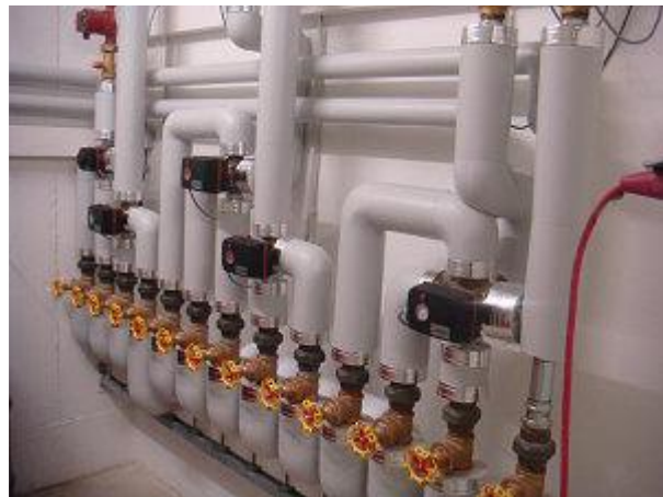
Ein Blick in einen der beiden identischen Technikräume
