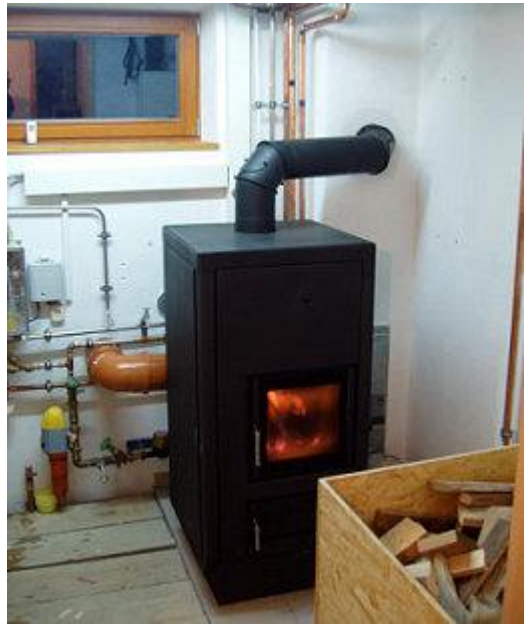
Ungewohnt: Der Holz-Zentralheizungskaminofen POWALL SONNE steht im Technikraum.
