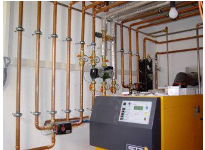
Ein Blick auf die Heizrauminstallation. Der 20 kW Holzvergaser-Heizkessel wird wenig gebraucht.
