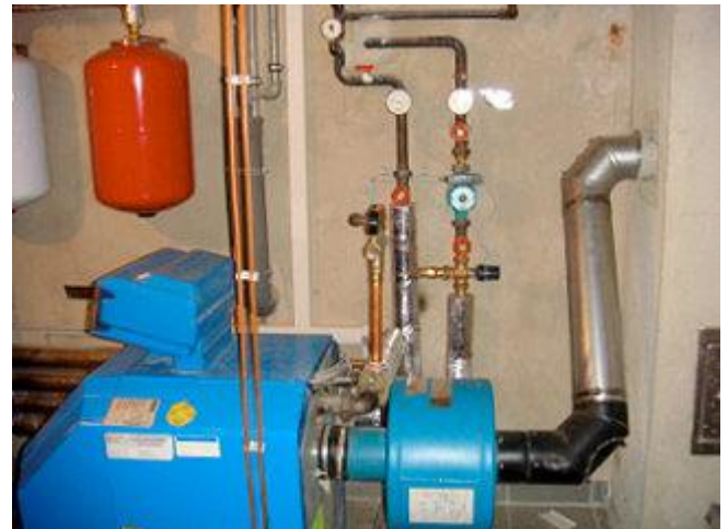
Der bestehende Öl-Heizkessel wird – als automatische Nachheizung für den Notfall – nur noch selten benötigt.
