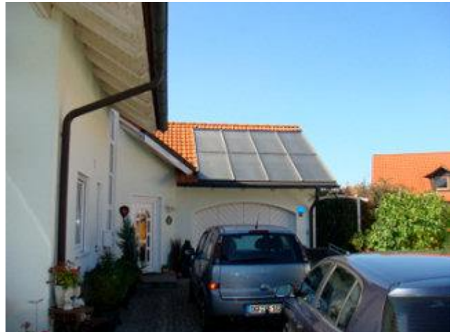
Ca. 16 m 2 Kollektor fanden auf dem Garagendach Platz.
