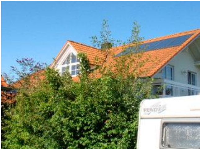
Links und rechts der Gaube wurden 10 bzw. 12 m 2 Hochleistungsflächenkollektor installiert. Die Fläche unterhalb kann für eine spätere Erweiterung oder für eine PV-Anlage genutzt werden.
