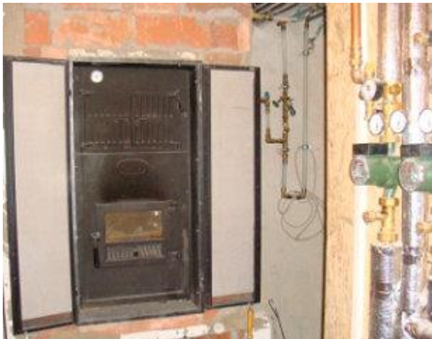
Der Einsatz des Zentralheizungs-Kachelofens wird vom Keller aus beheizt, über Warmluftschächte wird die Abwärme im Haus verteilt. Durch die hydraulische Einbindung in die Pufferspeicher kann nun ein größerer Anteil der Leistung wasserseitig genutzt werden.
