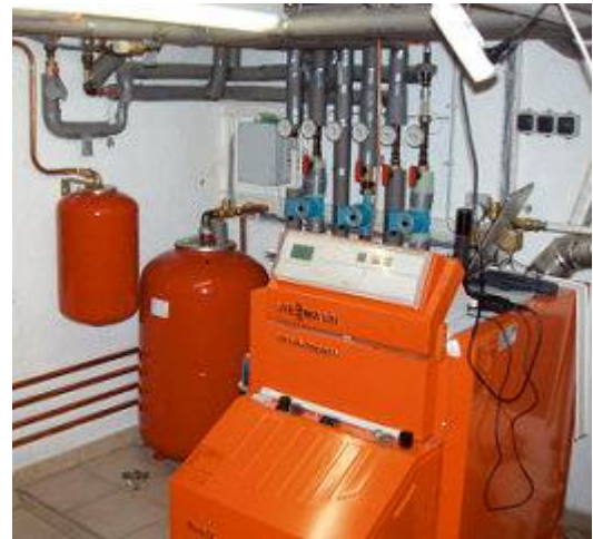
Der vorhandene Niedertemperatur-Öl-Heizkessel wird – integriert im neuen System - weiter betrieben.
