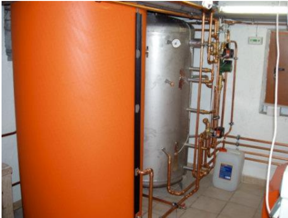
Ein Blick in den Technikraum nach der Rohinstallation: Die beiden Puffer haben jeweils einen Inhalt von 800 l und integrierte Glattrohr-Wärmetauscher für die Solarbeladung.
