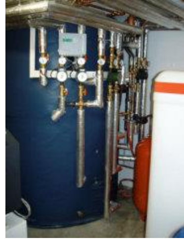
Der SWISS-SOLARTANK als Energiezentrale
