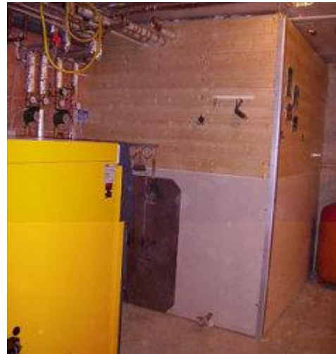
Hinter der Einhausung steht der SWISS-SOLAR-Kombispeicher mit integriertem Trinkwassererwärmer
