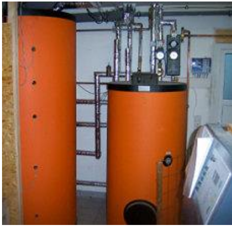
2 x 1.000 l Pufferspeicher und ein 400 l bivalenter Solarspeicher stehen für die Solaranlage und für den Holzvergaser-Heizkessel zur Verfügung
