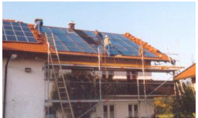
Auch die Solarstromanlage daneben hatte der Bauherr selbst gebaut.
