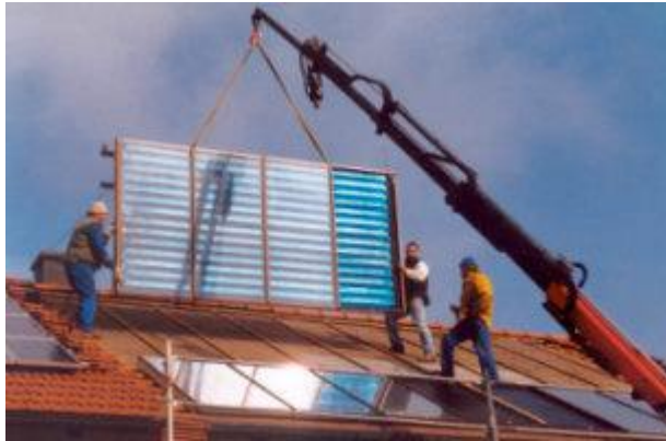
Die 48 m 2 große Kollektoranlage wurde komplett in Eigenleistung montiert.
