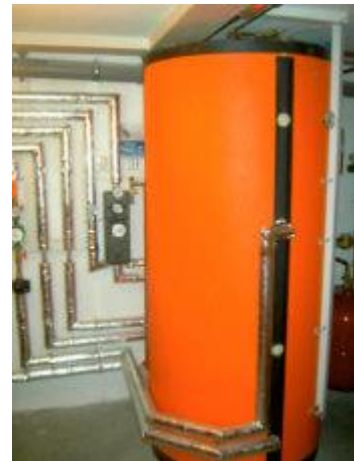
Der 1.000 l Solar-Kombispeicher mit integriertem Trinkwassererwärmer.
