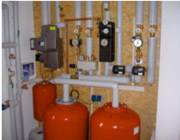
Der Technikraum: Hinter der Installationswand verbirgt sich der SWISS-SOLAR-Pufferspeicher
