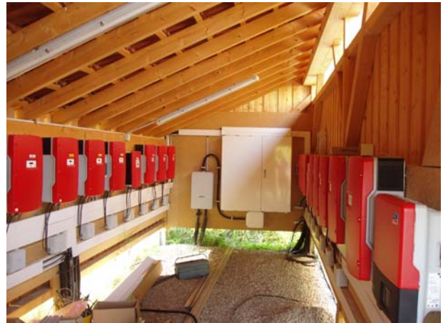
Ein Blick auf die Wechselrichter. Für die hohe Anschlussleistung musste der Stromversorger im Ort eigens einen neuen, stärkeren Trafo errichten.
