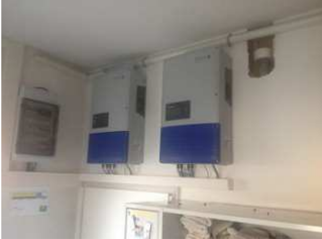
Die Wechselrichter im Nebenraum wandeln Gleichstrom in Drehstrom um
