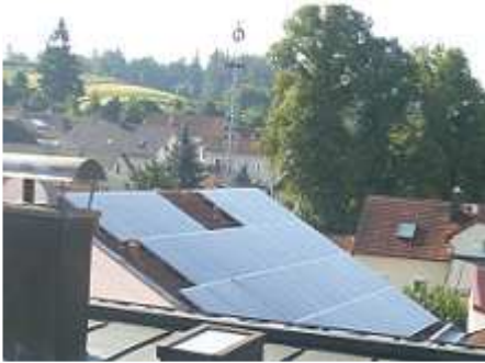
Die Anlage in der Johannesstraße.
