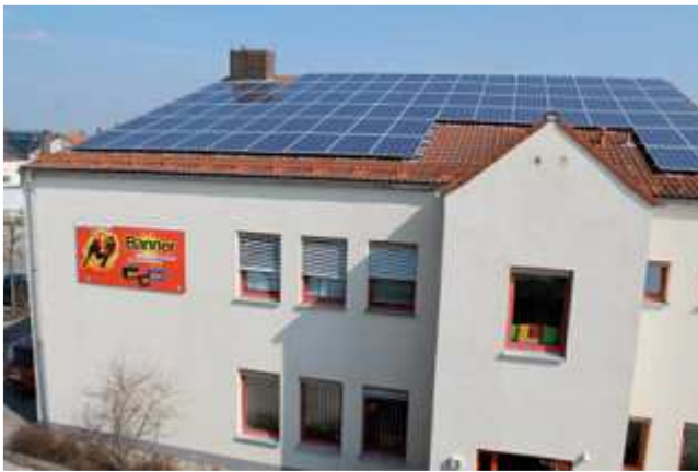
Teil 2 der Solarstromanlage wurde konventionell auf dem westorientierten Schrägdach montiert.
