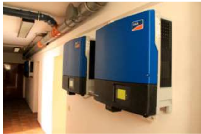
Die Wechselrichter wurden an einem kühlen Platz im Kellergeschoss installiert.
