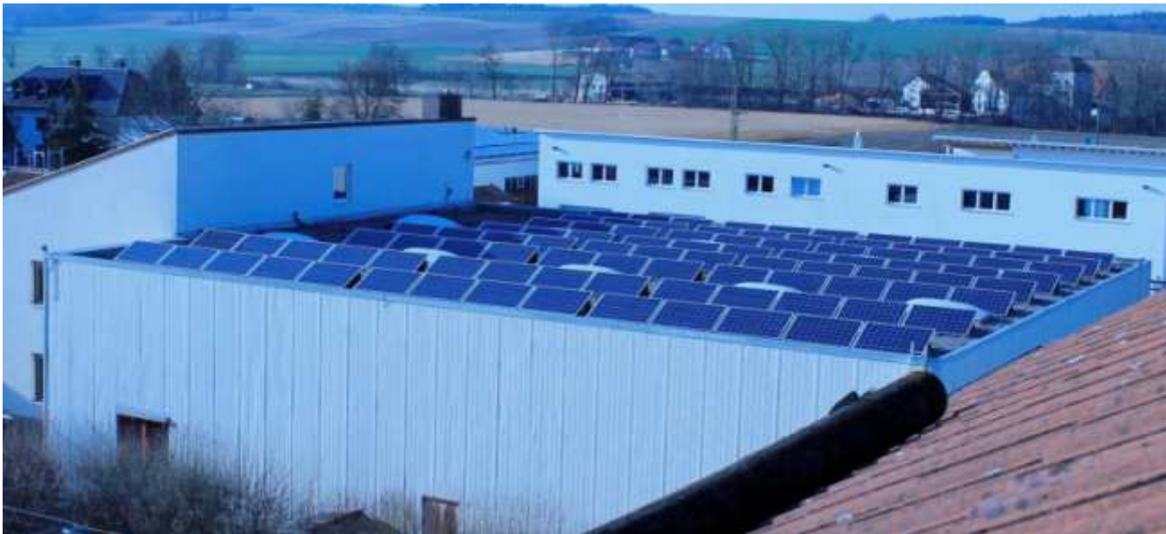
Teil 1 der Solarstrommodule sind auf dem Flachdach mit dem Suntub-System nach Süden hin aufgestellt.
