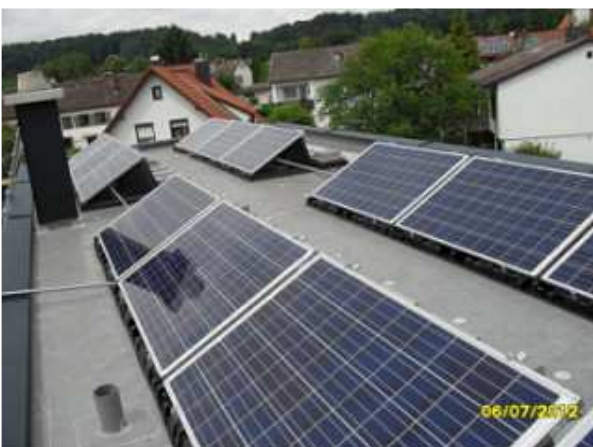
Die Querformat-Module auf dem Flachdach sind von unten praktisch nicht sichtbar.
