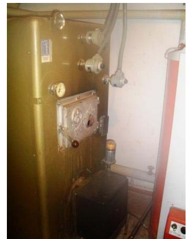
Der alte Kessel entsprach nicht heutigen Effizienzanforderungen.
