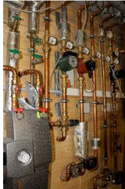
Der Technikraum nach der Rohinstallation. Die Installation ist komplett in einer Kellervertiefung untergebracht.
